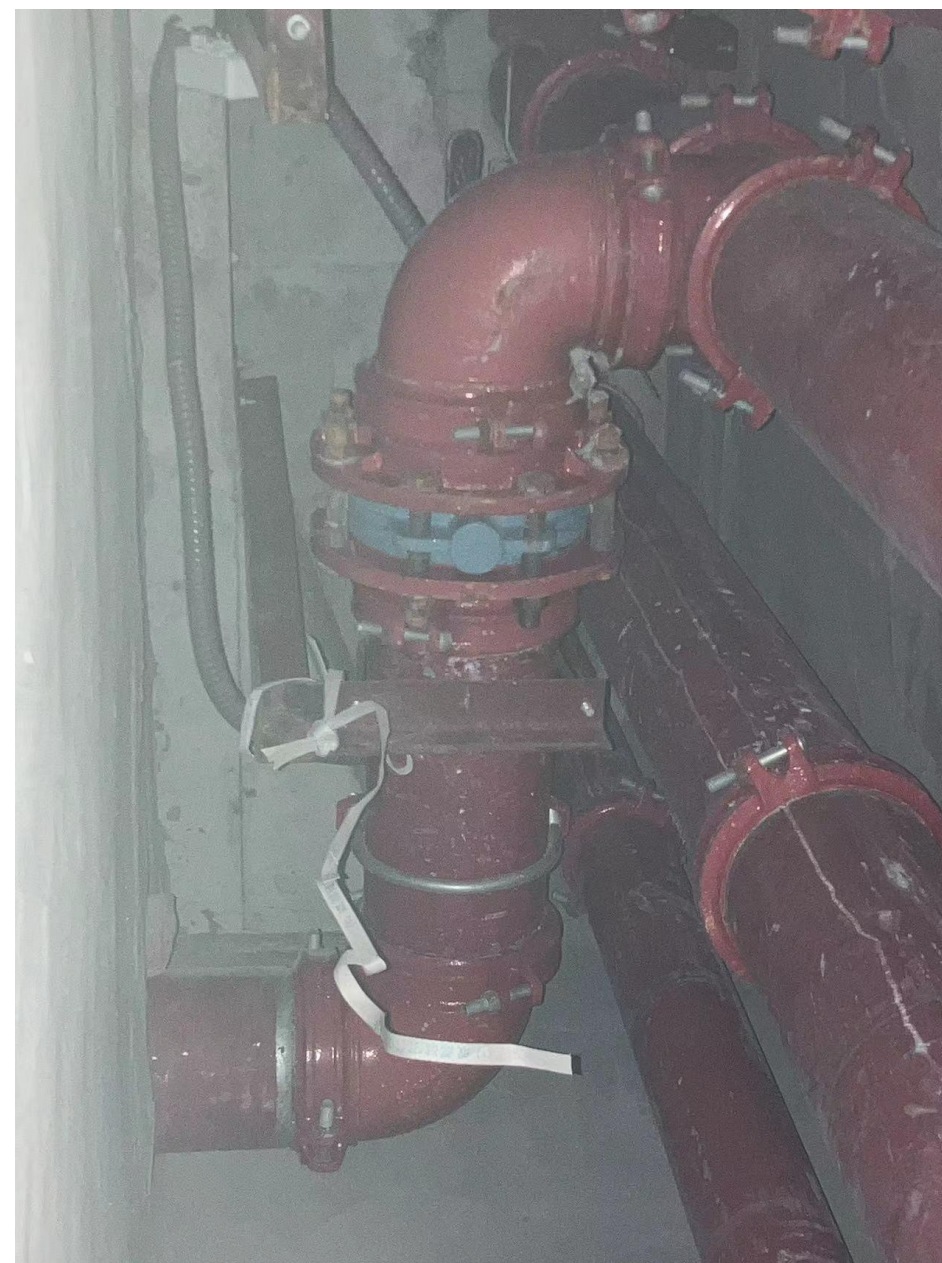
消防阀门损坏、无法关闭
