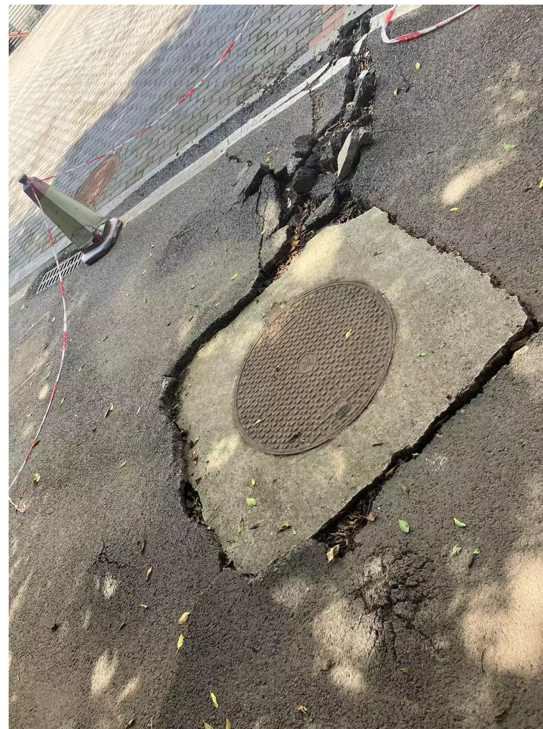
室外雨水管网、雨水井损坏
