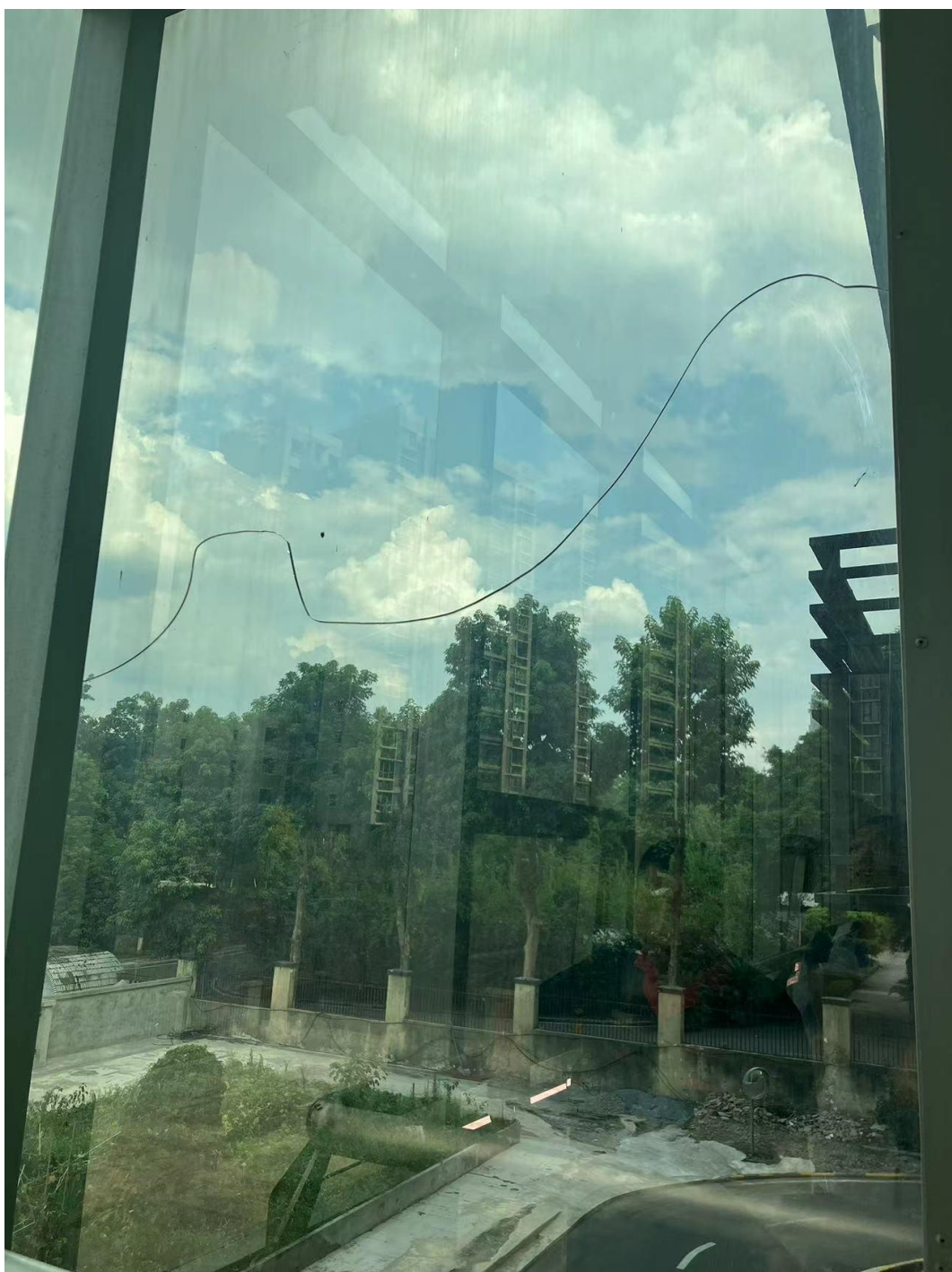
玻璃幕墙损坏
