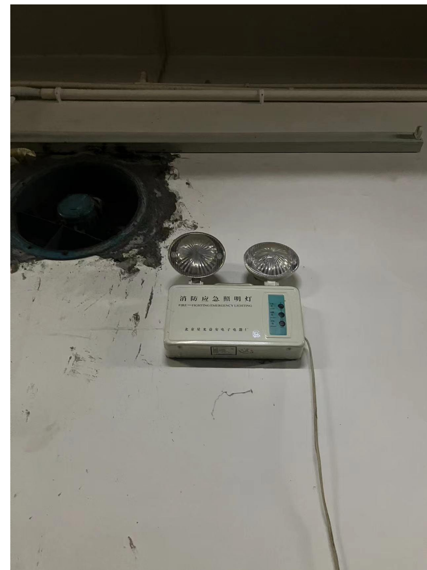
车库配电房应急照明灯损坏
